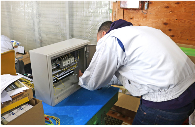
製造作業中の制御盤
