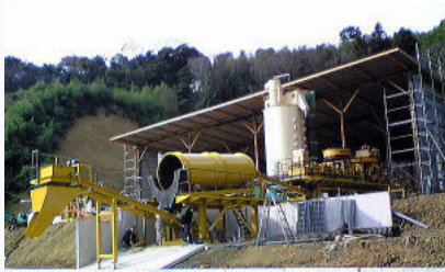
コンクリート生産装置
